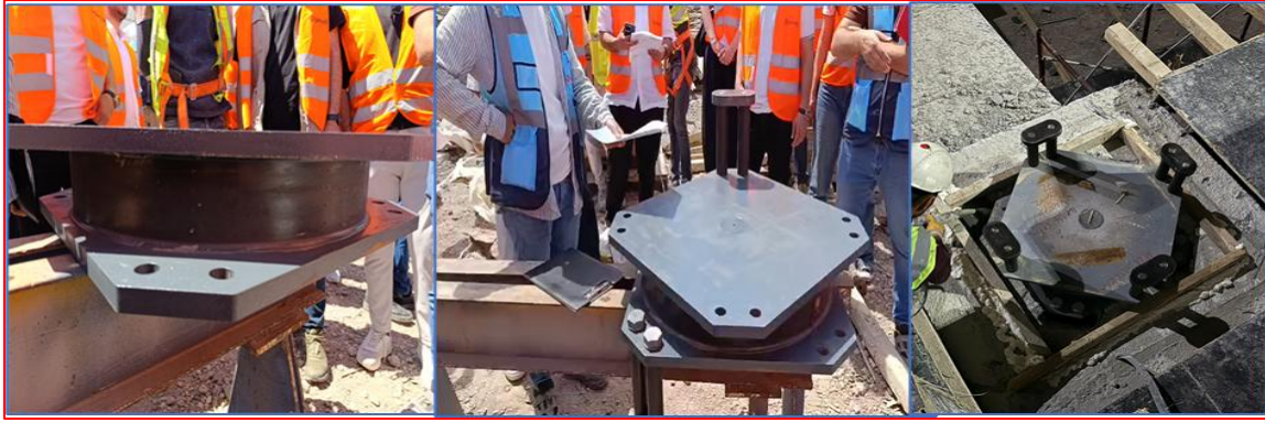
Şekil 8. Diyarbakır Şehir Hastanesi kauçuk ile sürtünme esaslı sismik izolatörler ve montajı
