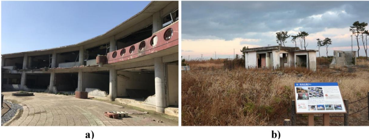
Şekil 3. Büyük Doğu Japonya Depremi Hasarlı yapılar, dışarıdan izlenen örnekler, a) Deprem Harabeleri Okawa İlköğretim Okulu [27], b) Arahama Bölgesi, Konut alanı[28]
