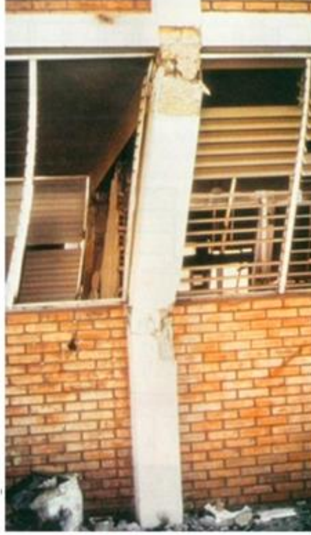
Fotoğraf 6: Bant pencerelerin kısa kolon etkisi ile hasar oluřturması örneđi (23 Aralık 1972 Managua Depremi, Mw=6,2) (1)
