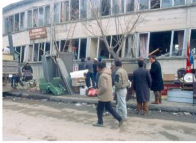
Fotoğraf 4: Bant pencerelerin kısa kolon etkisi ile hasar oluřturması örneđi (13 Mart 1992 Erzincan Depremi, Mw=6,8)
