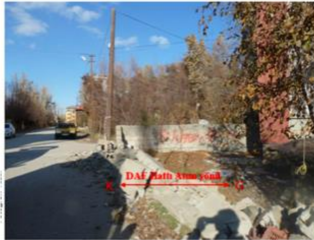
Fotoğraf 2: DAF (Doğu Anadolu Fayı) hattının atım yönüne dik olan duvarın yıkılmış, atım yönüne paralel olan duvarın yıkılmamış olması (23 Ekim 2011 Van Depremi, Mw=7,2).
