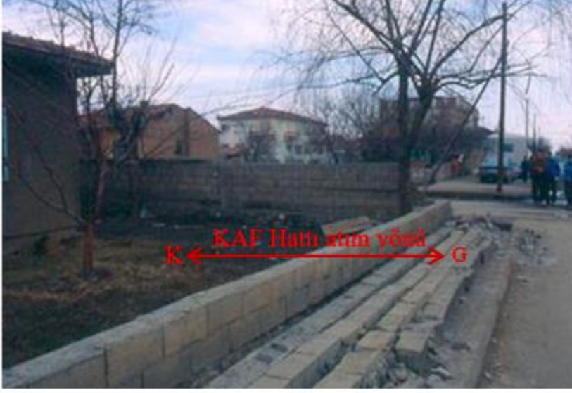
Fotoğraf 1: KAF (Kuzey Anadolu Fayı) hattının atım yönüne dik olan duvarın yıkılmış, atım yönüne paralel olan duvarın yıkılmamış olması (13 Mart 1992 Erzincan Depremi, Mw=6,8).
